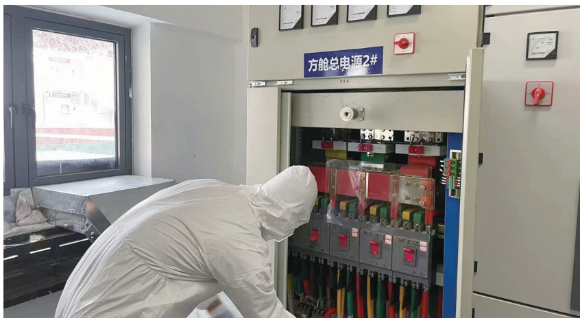
工作人员在检查电力设备。 图由国网西藏电力有限公司提供
