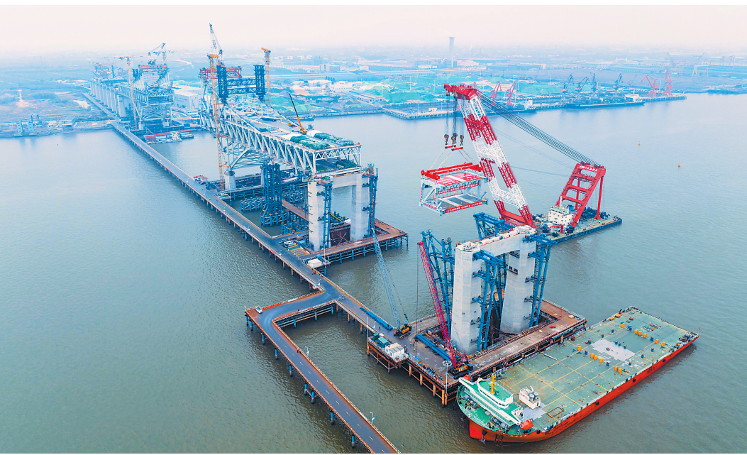
3月20日,常泰长江大桥主航道桥泰州侧首节段钢桁梁成功架设,标志着常泰长江大桥主航道桥钢桁梁架设工作全面展开。常泰长江大桥是一座公铁两用斜拉桥,连接江苏省常州市与泰州市。建成后,主航道桥主跨达1176米,将成为世界上跨度最大的斜拉桥。图为3月20日,中交二航局建设者在常泰长江大桥主航道桥泰州侧施工现场进行首节段钢桁梁架设(无人机照片)。
