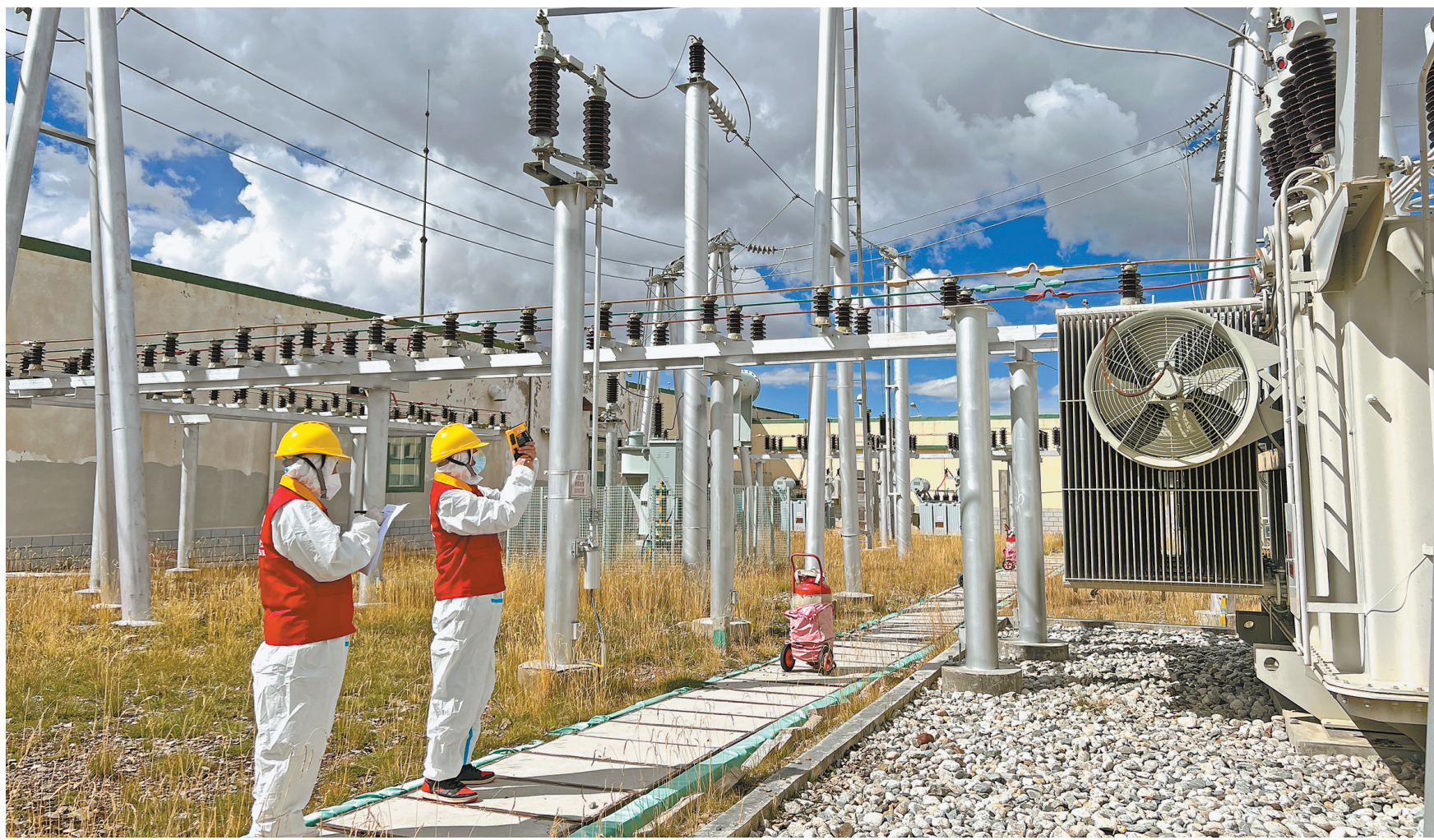
为了让市民国庆期间用电安心,国网那曲供电公司精心制订保电方案,认真排查治理安全隐患,全力保障全市人民在节日期间用上安全、放心电。 图为公司变电运检中心工作人员在对变电站主变进行红外测温。
