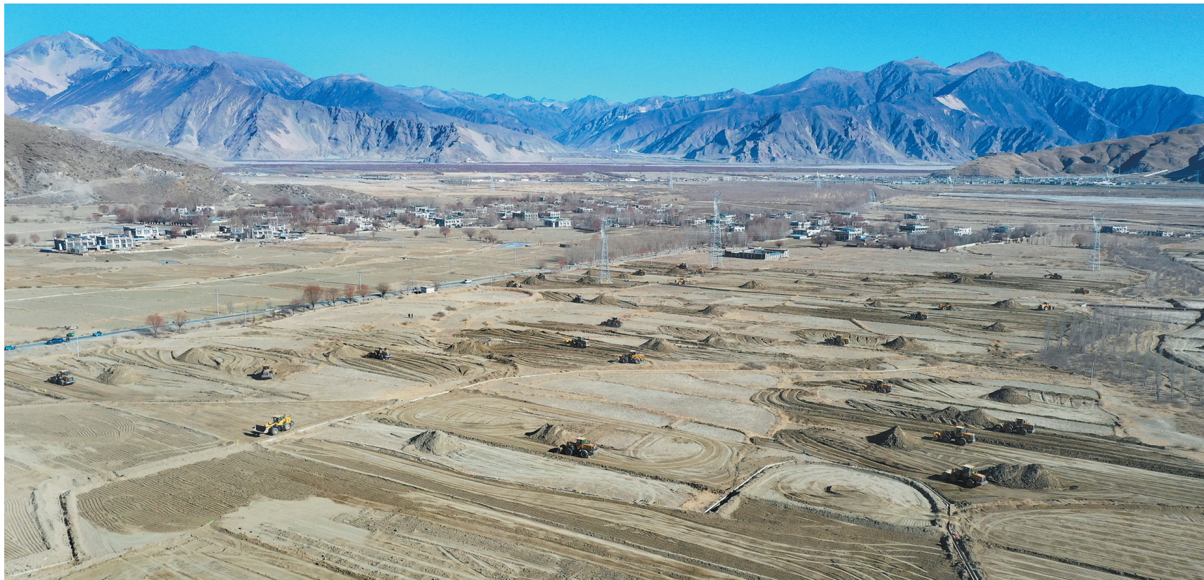
近年来，山南市贡嘎县积极实施高标准农田建设项目，2021年11月30日开工建设的东拉乡广嘎村、杰德秀镇果吉村、朗杰学乡岗则村3400亩高标准农田建设项目，总投资为1029.81万元，目前已完成土地平整工程量的52.63%。图为贡嘎县杰德秀镇高标准农田建设现场。 本报记者 洛桑 摄
