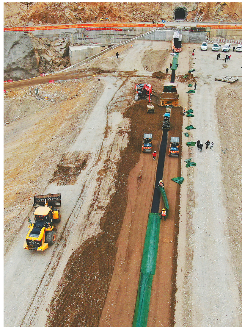
西藏湘河水利枢纽及配套灌区工程,是国务院确定的172项重大节水供水水利工程之一,也是我区水利改革发展“十三五”规划的重点骨干工程。工程总投资约27亿元,2019年4月开工建设,计划于2022年12月完工。截至目前,湘河水利枢纽及配套灌区工程完成总进度的约80%,各项施工仍在紧锣密鼓地推进。 图为湘河水利枢纽及配套灌区工程施工现场。 本报记者 李洲 摄
