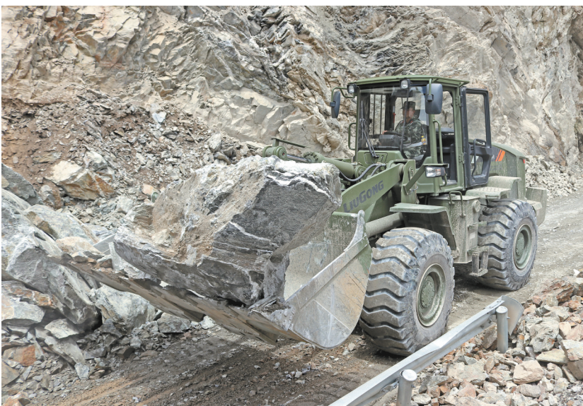
图为武警官兵正在清理塌方巨石。
