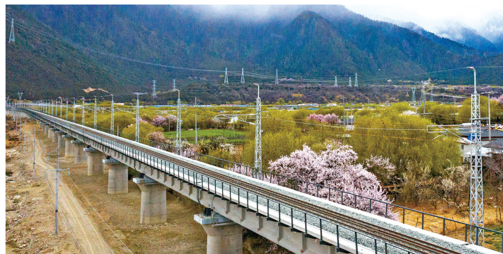
西藏分行全力做好川藏铁路建设涉及的勘察设计、物资保障、装备研发制造、轨道科研创新和项目施工建设全流程领域配套金融服务工作。图为川藏铁路拉林段。
