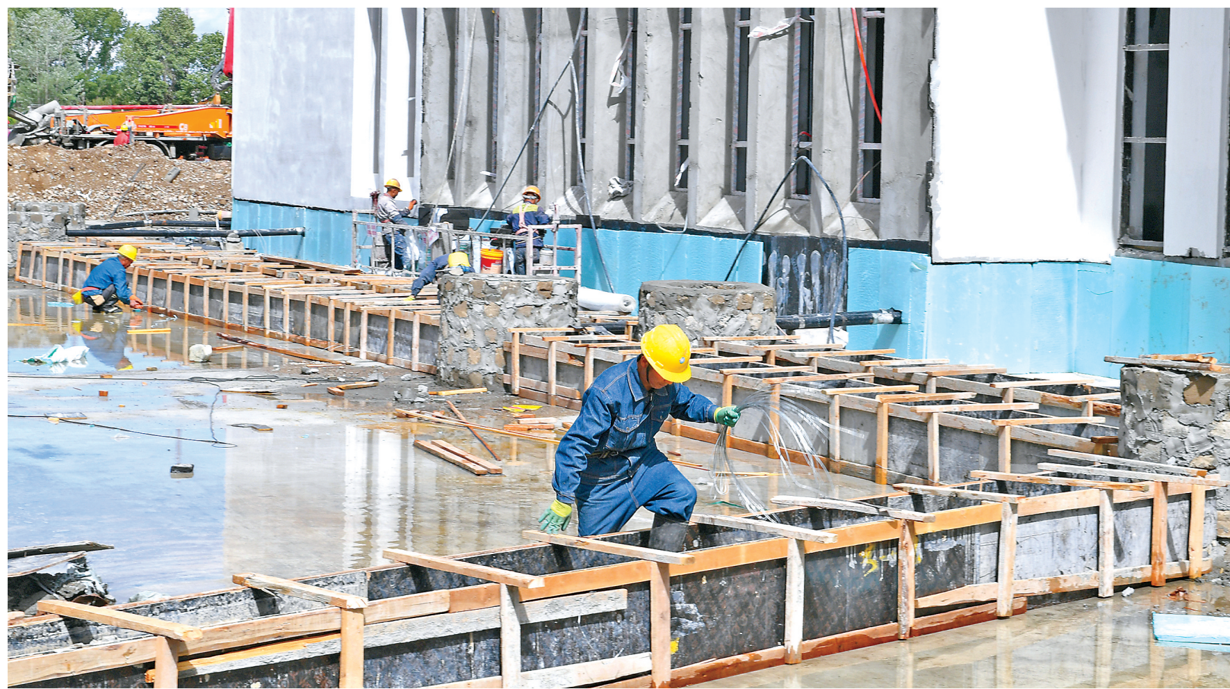
近年来,我区牢固树立以人民为中心的发展思想,以满足人民群众对城市建设的新期待、新要求为出发点,高标准谋划推进城市建设工作。图为拉萨师范高等专科学校迁建项目施工现场。 本报记者 丹增群培 摄
