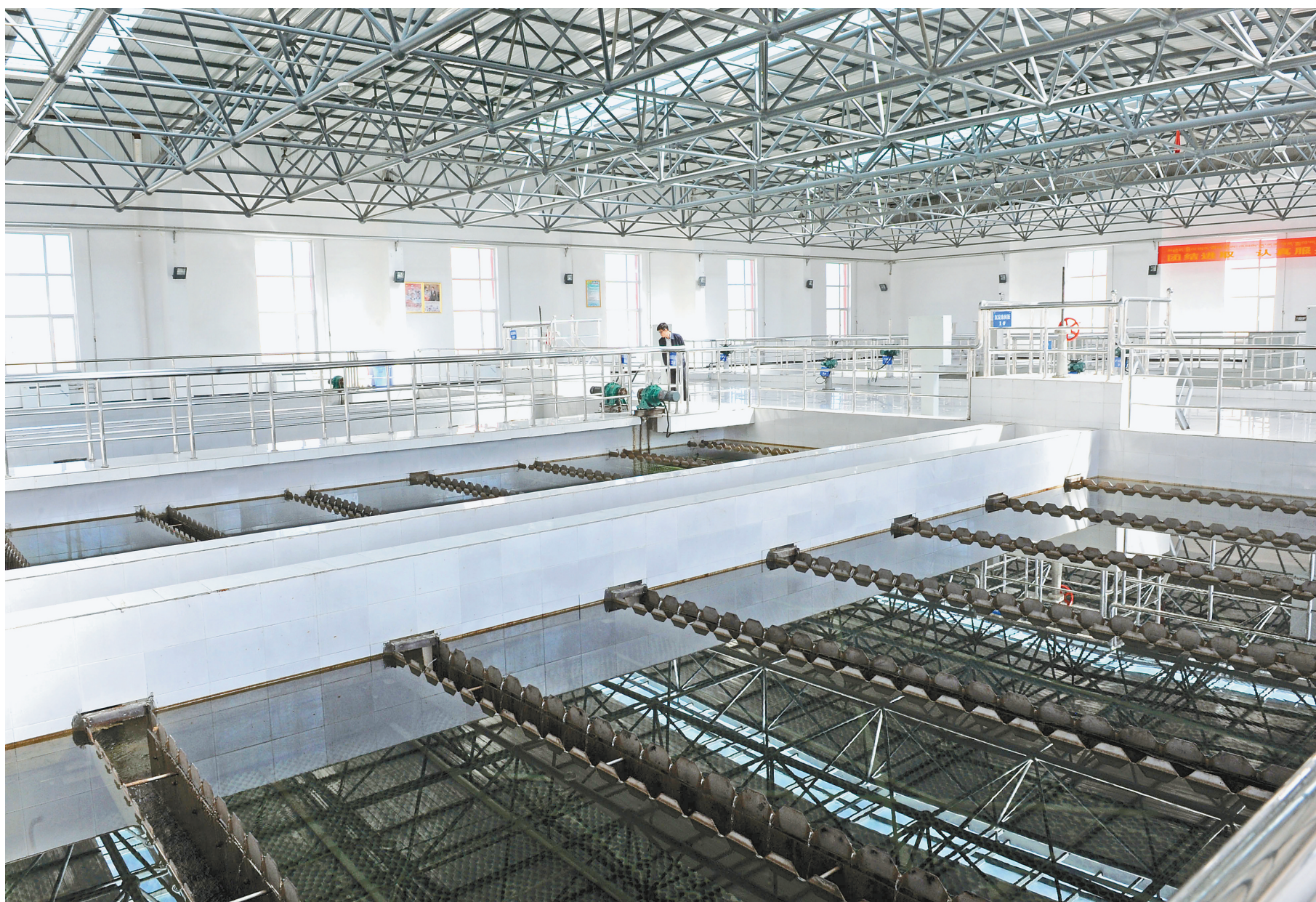
▲图为那曲市污水处理厂一角。
